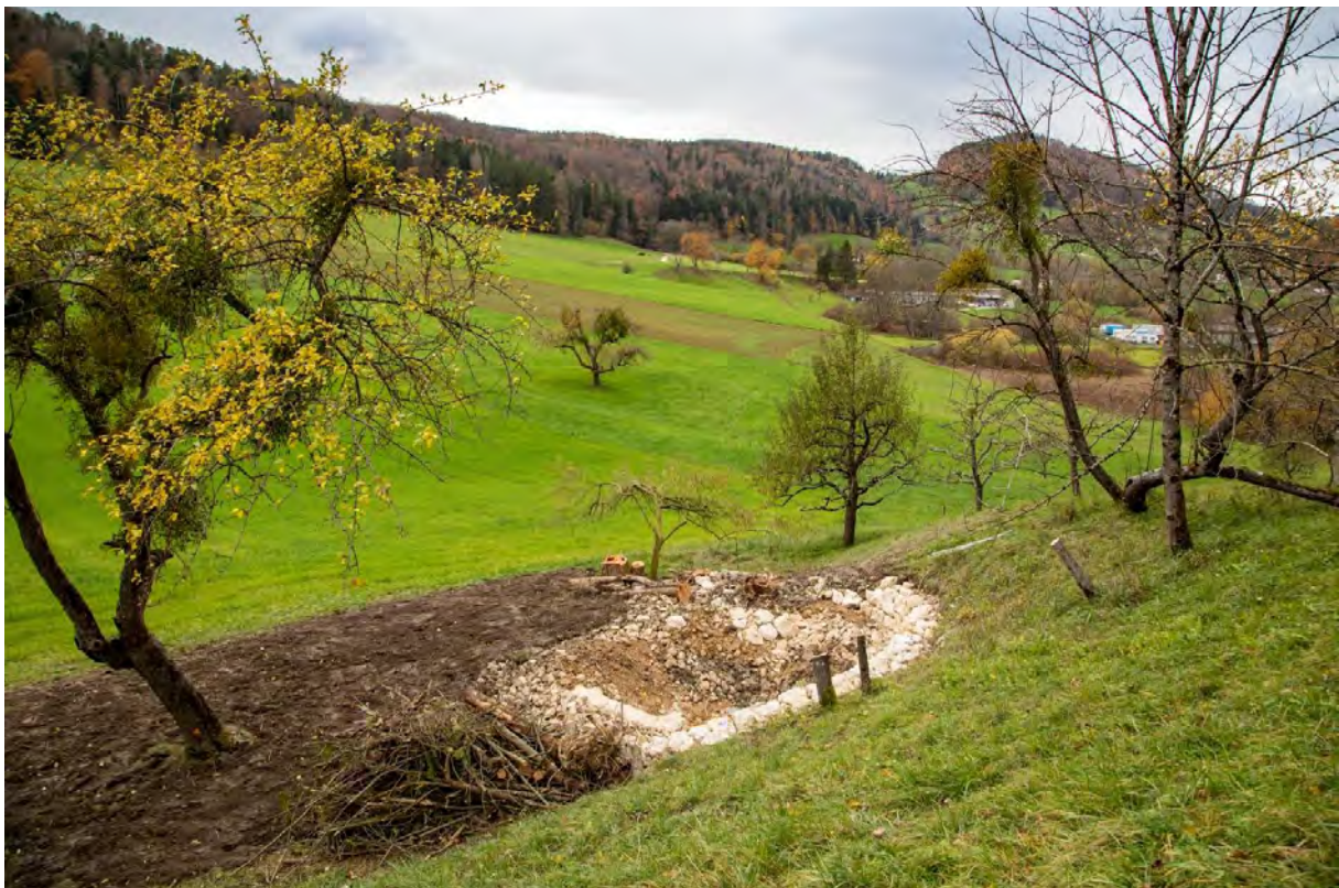
Abb. 14: Das fertige Bauwerk mit den abgeschlossenen Umgebungsarbeiten. Der Weiher ist parat, um durch Niederschläge befüllt zu werden und im Frühling als Laichplatz zu dienen (Foto: M. Staub).
