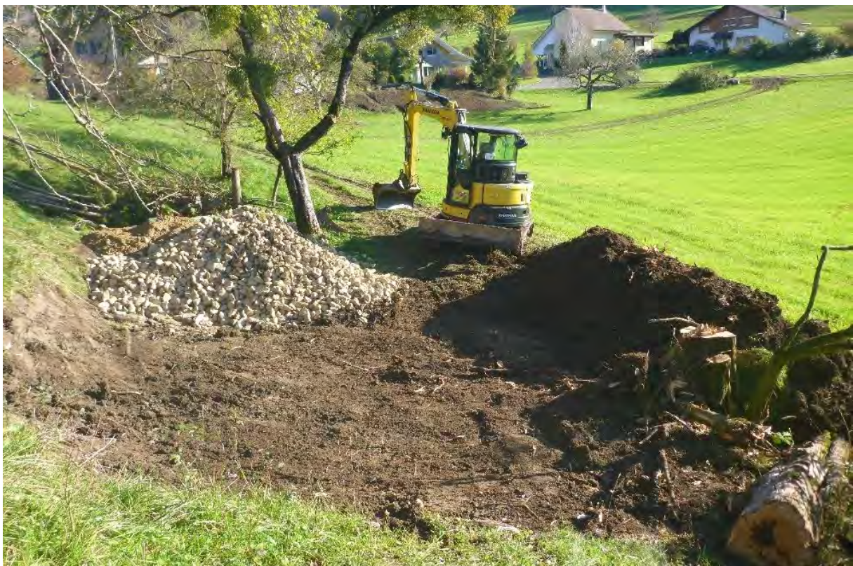
Abb. 6: Nach den Rodungen wurde der Baubereich abhumusiert und die Materiallieferungen in einer trockenen Phase vorgenommen. So konnte das Landwirtschaftsland bestmöglich geschont werden.
