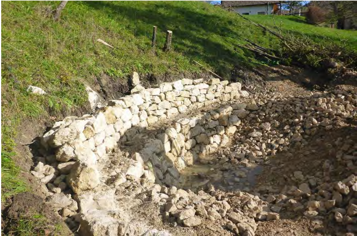
Abb. 11: Die Trockenmauer wird hintermauert mit kleinen Kalkmauersteinen und Kalkschroppen. Zwischenräume werden mit Kalksand und Gelbkies hinterfüllt. Die Mauer bietet so verschiedene Lebensräume unter Berücksichtigung ihrer Stabilität.
