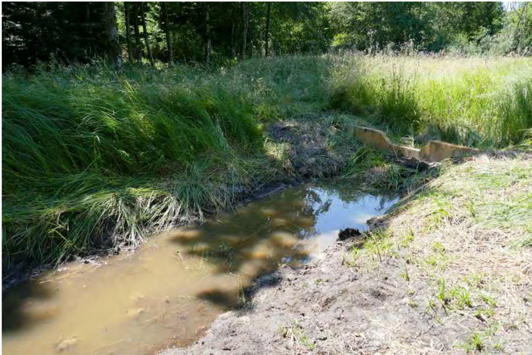
Abb. 5: Sechs Wochen nach Erstellung der Spundwände ist der westliche Randgraben zur Hälfte eingestaut (24. Juni 2023). Zur Gewinnung von Erdmaterial und Lehm für die Grabenverfüllungen haben wir 5 kleine Geländemulden mit flachen Böschungen ausgehoben. Sie sollen mit dem Anstieg des Bodenwasserspiegels zu Weihern werden.
