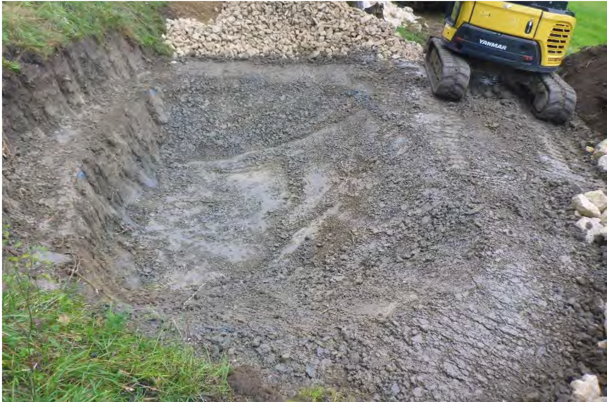
Abb. 7: Die Aushubarbeiten sind abgeschlossen, das Planum fertig. Im linken, steilen Bereich wird die Trockenmauer erstellt.
